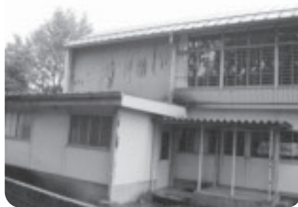
塗装の劣化した体育館
