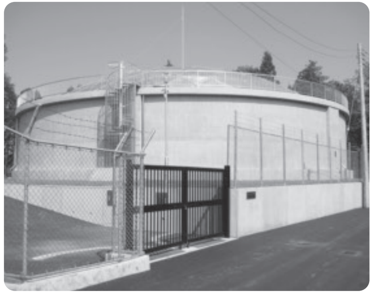
芳賀中部上水道企業団 芳志戸配水池
