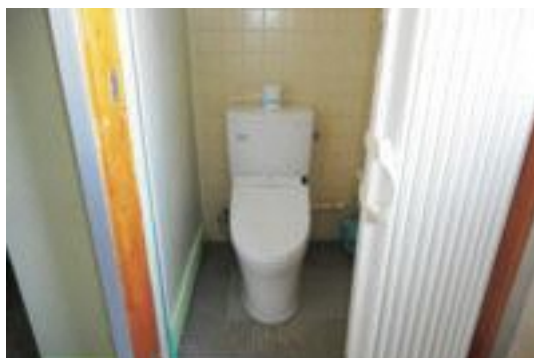
▲水橋分館アコーディオン式扉のトイレ
