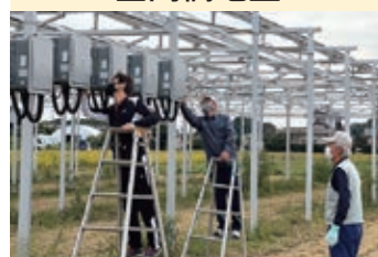
営農型太陽光発電施設からの電力供給確認
