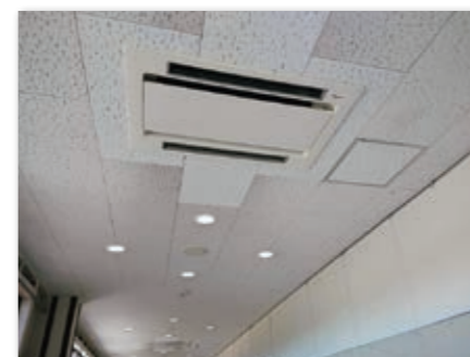
▲高効率化された空調・照明
