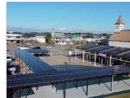
▲通路屋根の太陽光パネル
