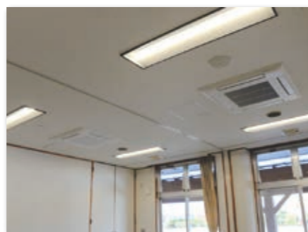
▲高効率化された空調・照明
