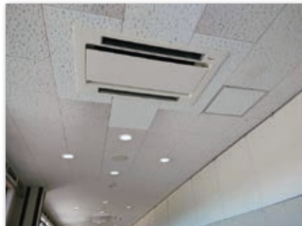
▲高効率化された空調・照明
