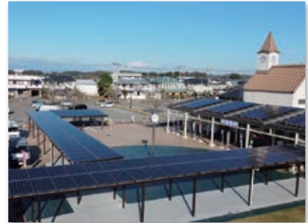
▲通路屋根の太陽光パネル
