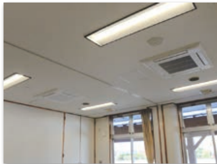
▲高効率化された空調・照明
