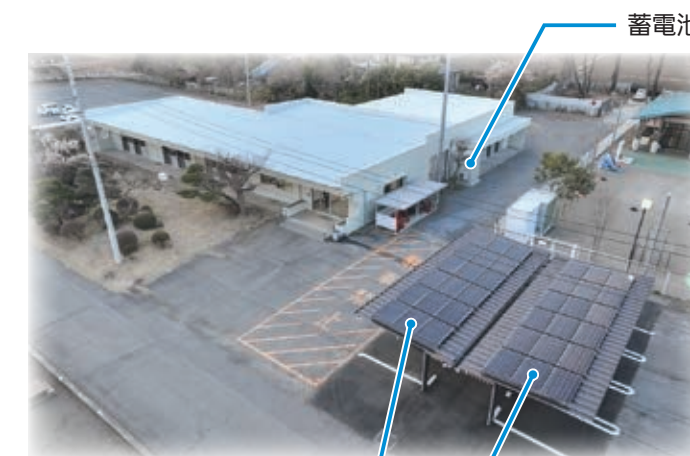
太陽光パネル
