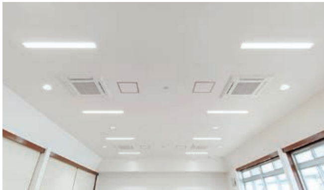
▲高効率化された空調・照明
