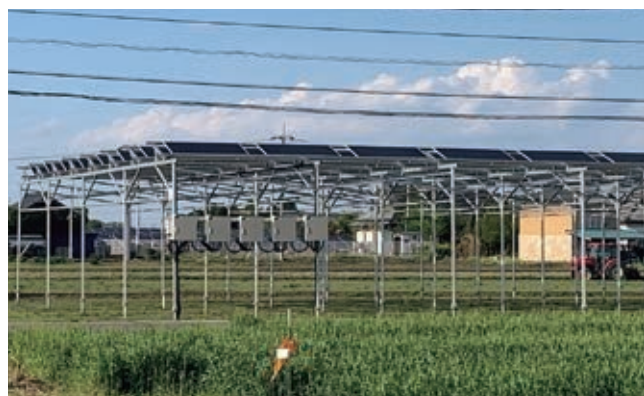
▲営農型発電設備
