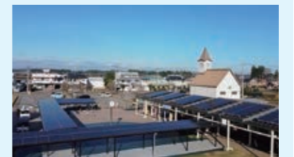
▲道の駅はがに設置された太陽光パネル
