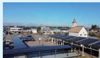
▲道の駅はがに設置された太陽光パネル
