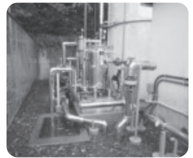
ロマンの湯メタンガス除去装置
