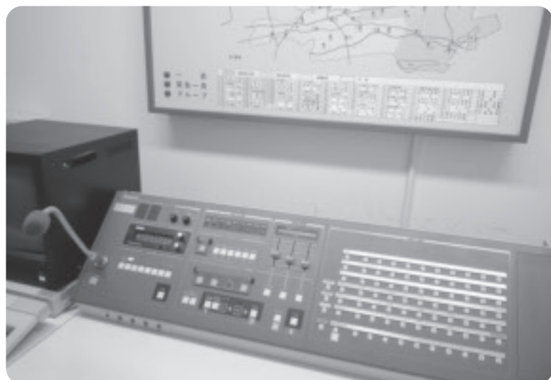
防災無線の装置
