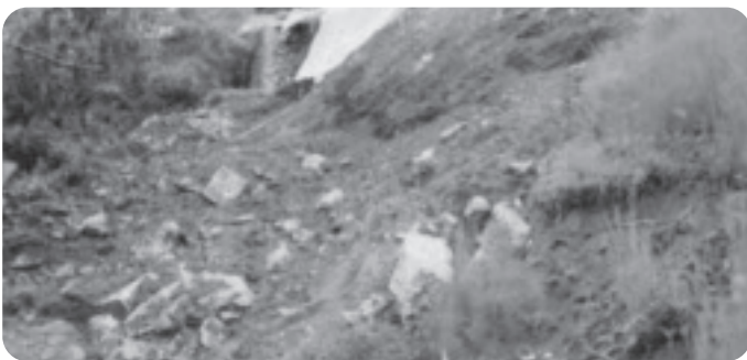
みどりヶ丘団地西側「崩落した擁壁」
