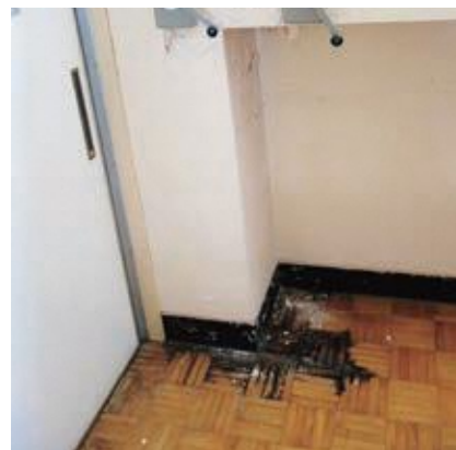
▲与能分館雨漏り
