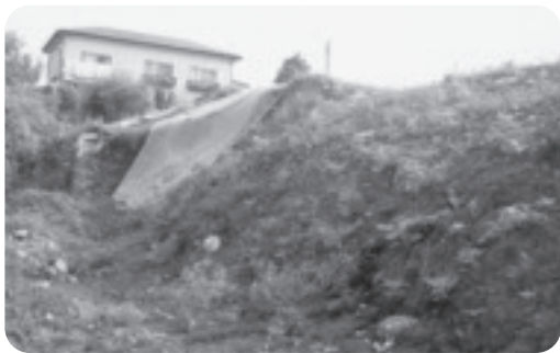
崩落した擁壁 みどりヶ丘団地(下高根沢)
