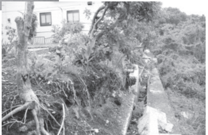
▲みどりヶ丘団地崩落現場
