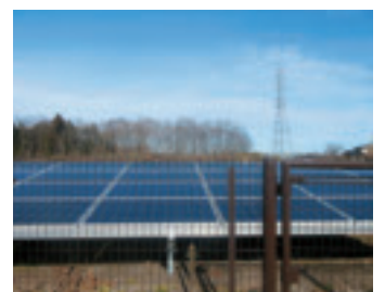
▲町内の太陽光発電施設
