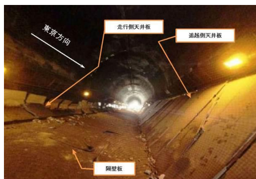
〔笹子トンネル天井板の落下状況〕 （国土交通省HP トンネル天井板の落下事故に関する調査・検討委員会より）
