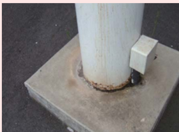
ポールの根元にサビが発生
