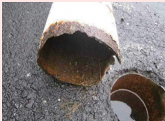
ポールの根腐れによる倒壊
