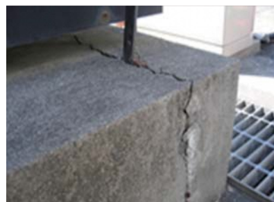
看板基礎のひび割れ
