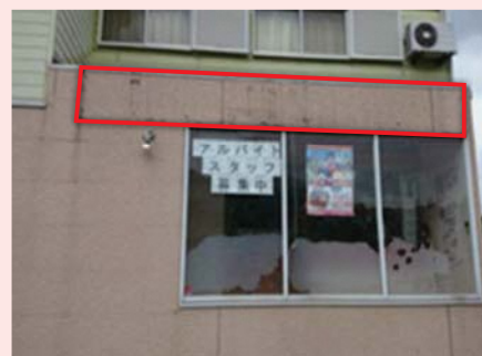
落下した後の壁面
